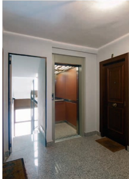
Edificio después de la instalación.
